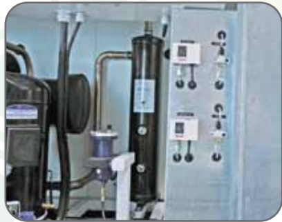
Panel Control de Presiones: Transductores de presión y presostatos electromecánicos para controlar la presión de succión y descarga.
