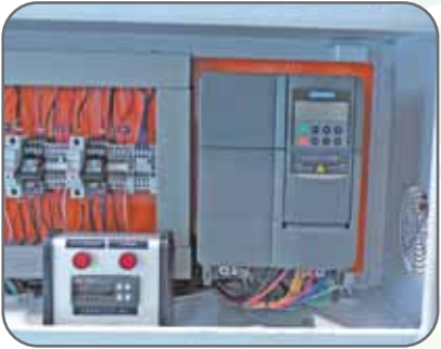
Variador de Velocidad: La velocidad de los motores de los ventiladores es controlada dependiendo la temperatura de condensación.
